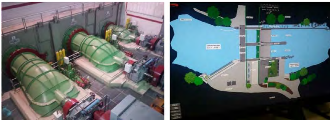
Figura 6.6: Le turbine Kaplan installate ed un'immagine del sistema di controllo
