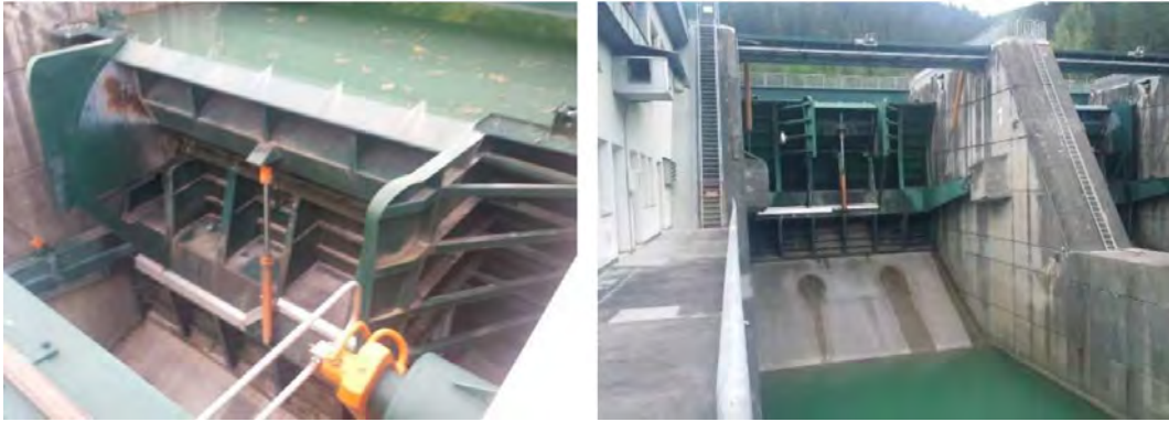
Figura 6.8: Lo sbarramento è dotato di due paratoie di settore
