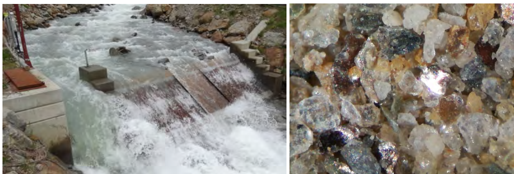
Figura 3.10: La presa dell'impianto Saldur (Val di Mazia) ed immagine del materiale solido tipico del Rio Saldura
